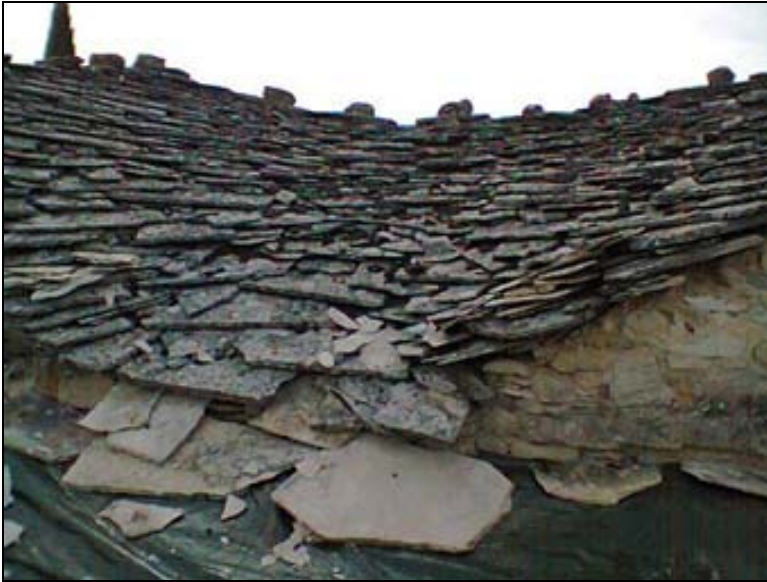
Vue partielle d'un toit en bien mauvais état avant les travaux.
