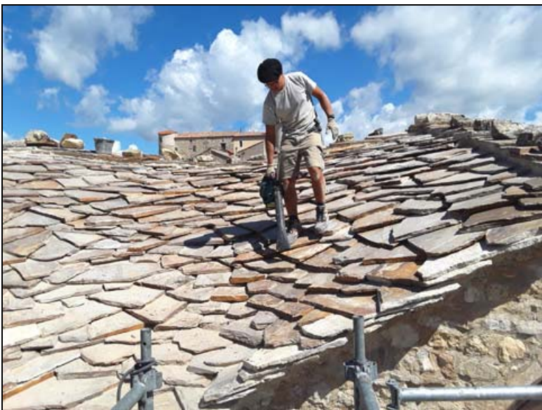
M. Benoit Bigord, apprenti venu quelques jours pour aider M. Stéphane Metge, passe l'aspirateur sur le toit terminé.
