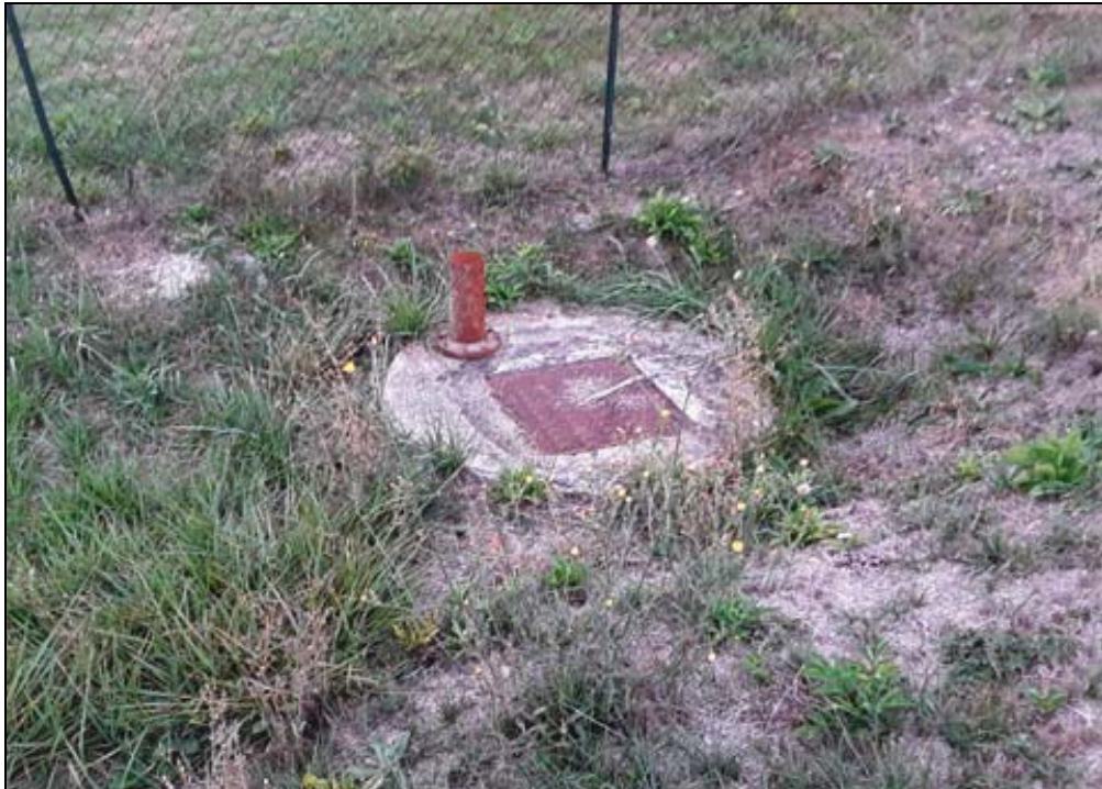
Regard qui permet le réglage du débit de l'eau qui va vers les 3 fontaines du village.
