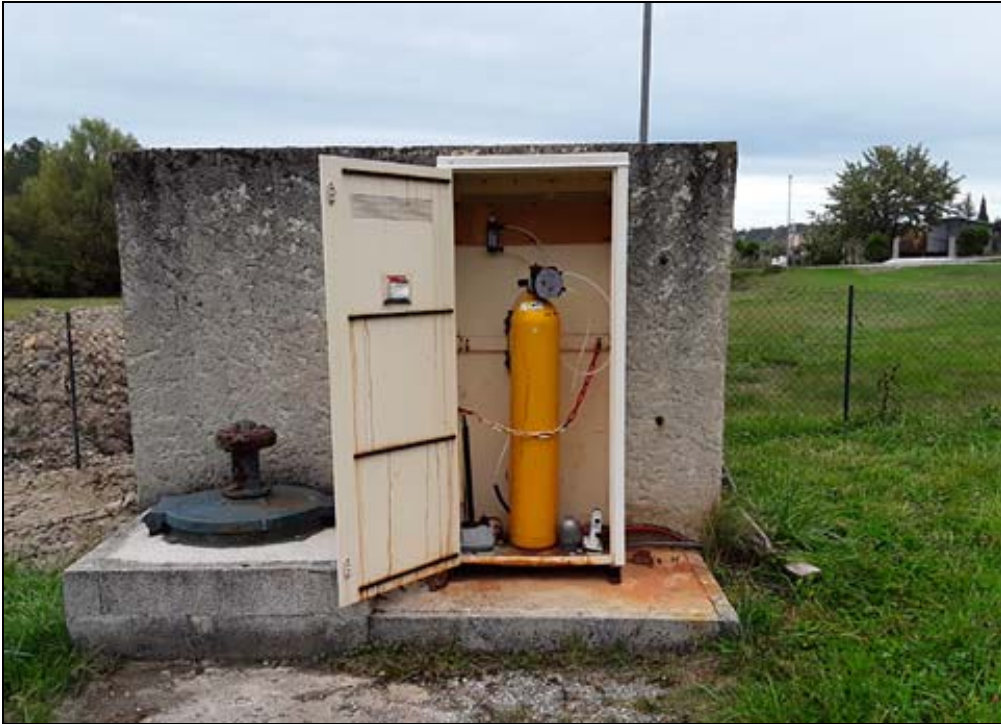
Local où est placée la bouteille de chlore tout contre la station.
