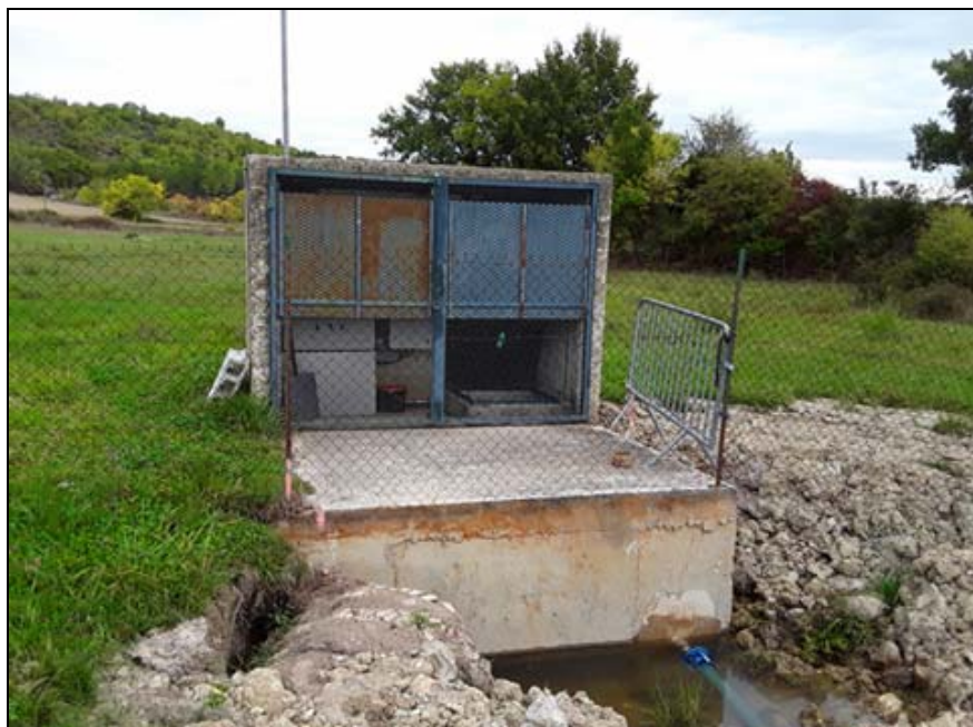
Station de pompage - local à pompes.
